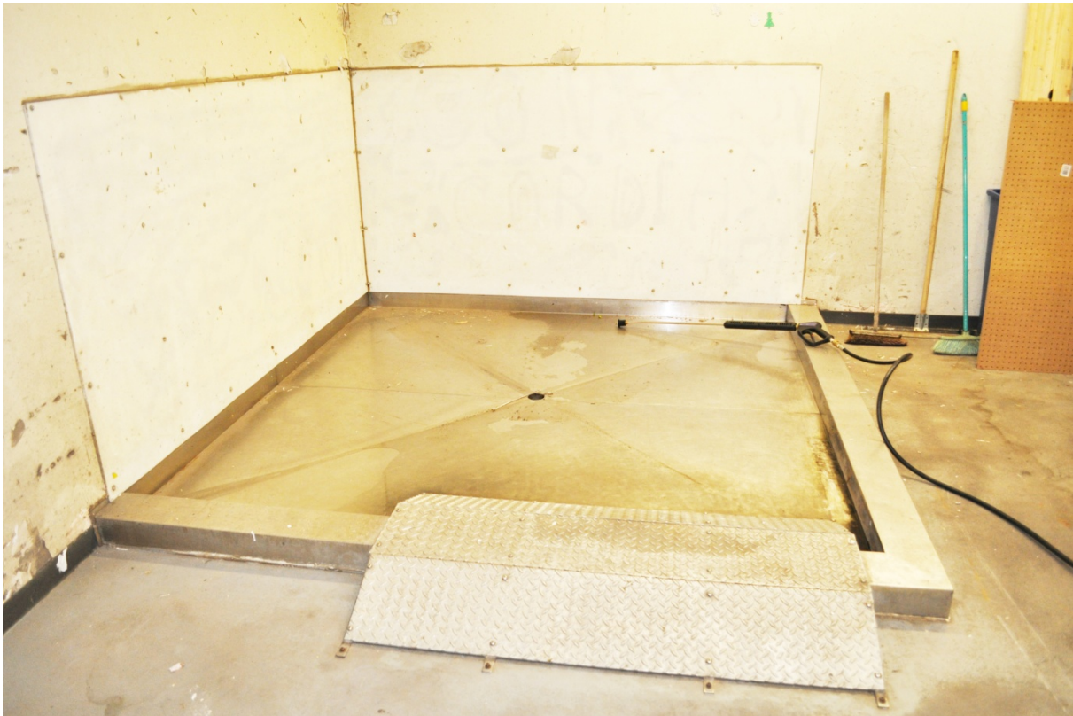
Figure 37: Installation intérieure pour laver les bacs de collecte utilisant un nettoyeur à pression (photo Alexis Fortin).
