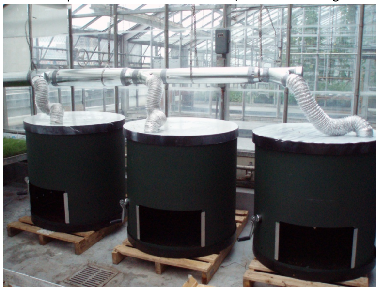
Figure 94: Vermicomposteurs de type Wig Wam équipés de ventilation, installés dans une serre sur le toit d'un édifice au centre-ville de Montréal (photo Louise Hénault-Ethier).
