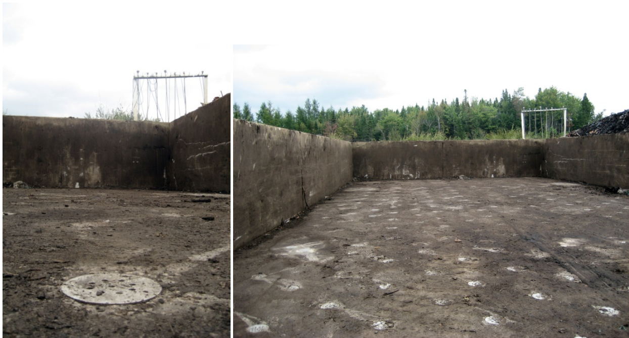
Figure 16: Les piles statiques aérées, aussi appelées piles statiques sous aération forcée. En a) on voit le détail d'une sortie d'aération et en b) on voit l'ensemble de la baie où se fait le compostage sous pile statique aérée.
