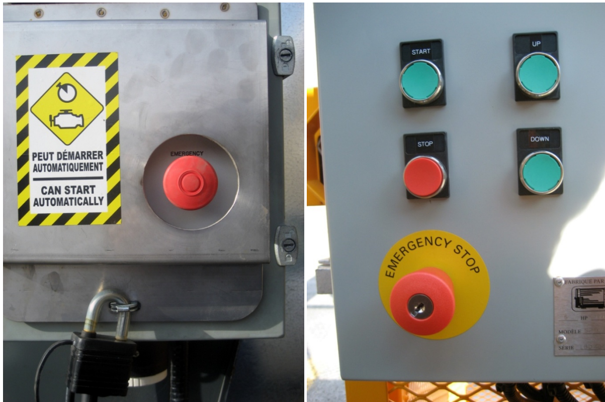
Figure 58: Boutons d'arrêt d'urgence sur un équipement mécanique. (a) Ce bouton doit être bien visible et facilement accessible même si un panneau de contrôle doit rester barré. (b) Par mesure de sécurité supplémentaire, certains boutons nécessitent une clé pour être désengagé après un arrêt d'urgence (photos Alexis Fortin).
