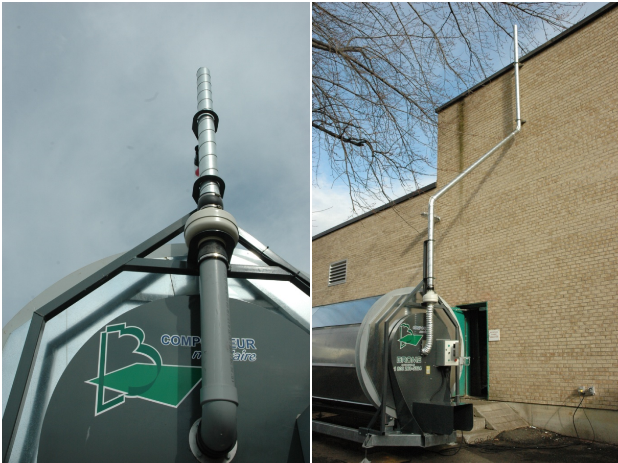
Figure 84: Cheminée pour évacuer et diluer l'air sortant d'un composteur (a) cheminée de faible hauteur installée dans une aire ouverte près d'une institution (photo Louise Hénault-Ethier) et (b) cheminée qui surplombe le toit d'un commerce (photo Paul Larouche).
